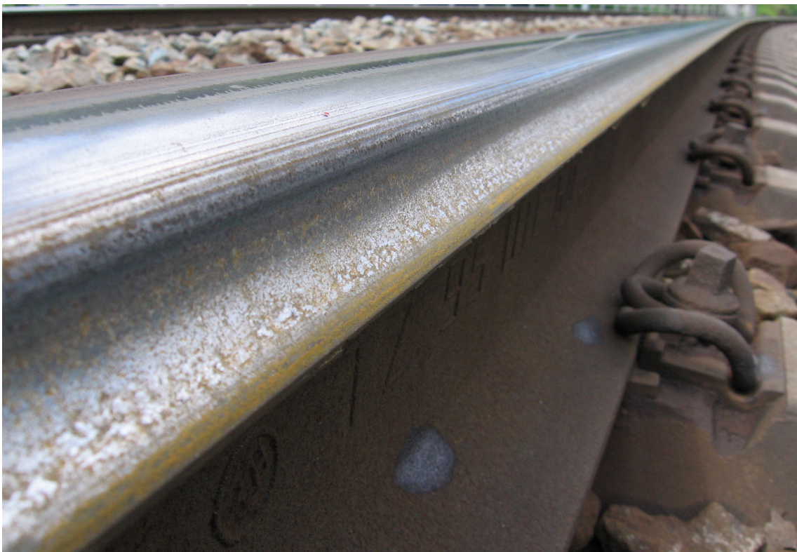
Obr. 1 Boční opotřebení vnějšího kolejnicového pásu
