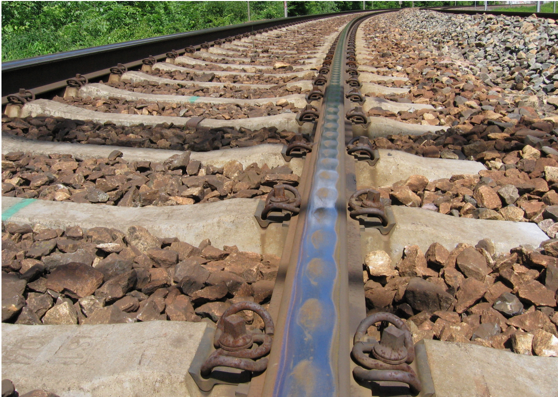
Obr. 2 Podélný profil vlnovitosti na hlavě kolejnice (trať Brno - Adamov)
