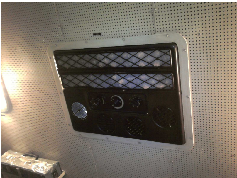
Obrázek 23: Klimatizační jednotka lokomotivy ř. 163. Vyrobeno 80-léta 20 století zdroj: autor
