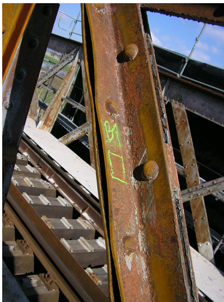
Obr. 11 - Detail koroze mezi nýtovaným ztužením příhrady
