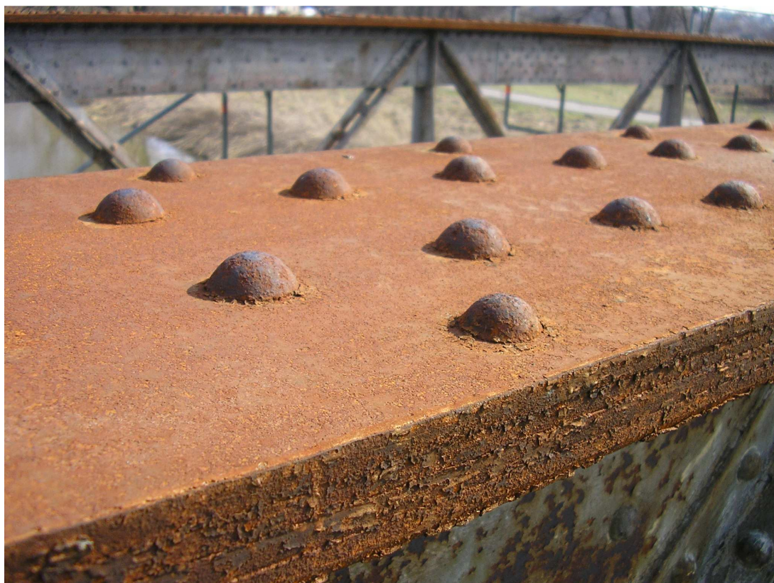
Obr. 5 - Detail stavu horní pásnice
