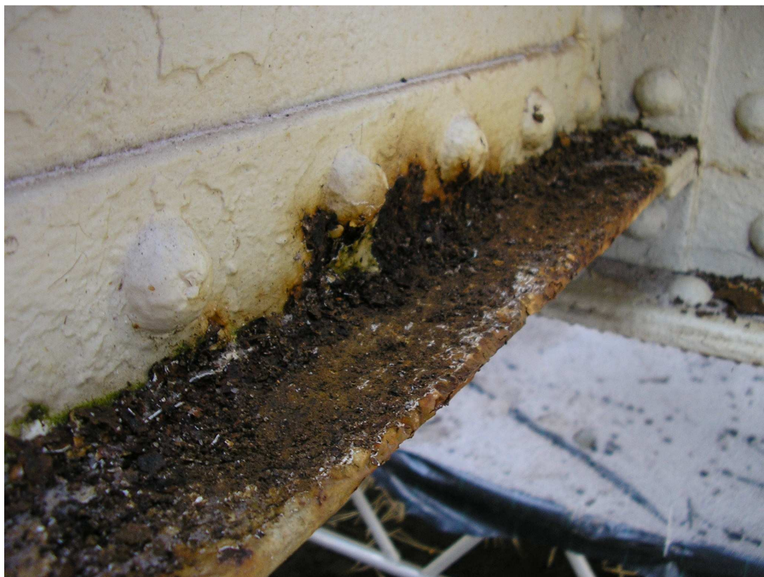
Obr. 12 - Nejvíce postižené místo celé konstrukce
