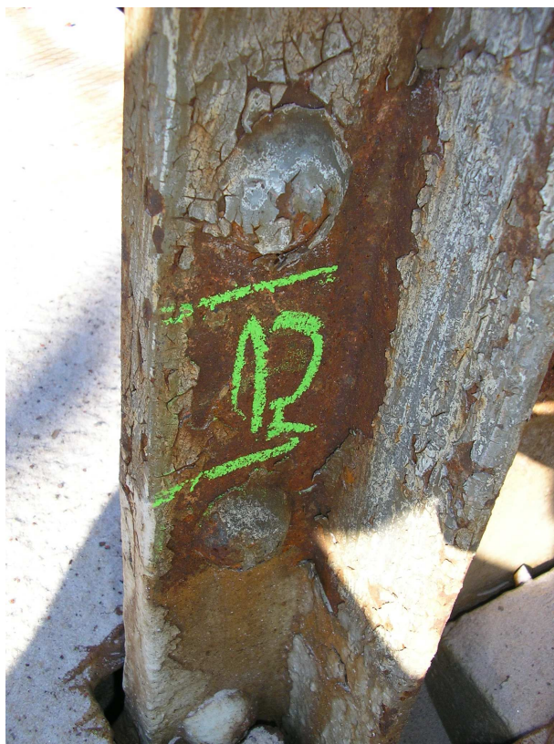
Obr. 8 - Označení vybraného místa před odstraněním koroze
