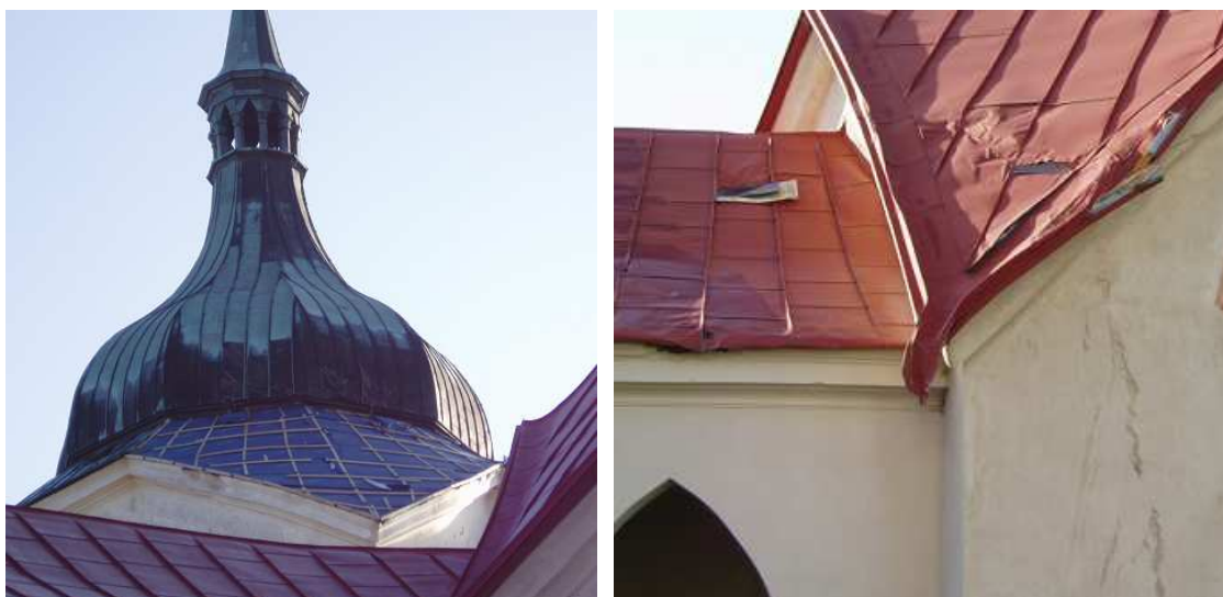
Obr. 31 a 32 - Kostel sv. Jana Nepomuckého - opravovaná střecha kostela sv. Jana Nepomuckého po vichřici, na druhém obrázku stále zničená
