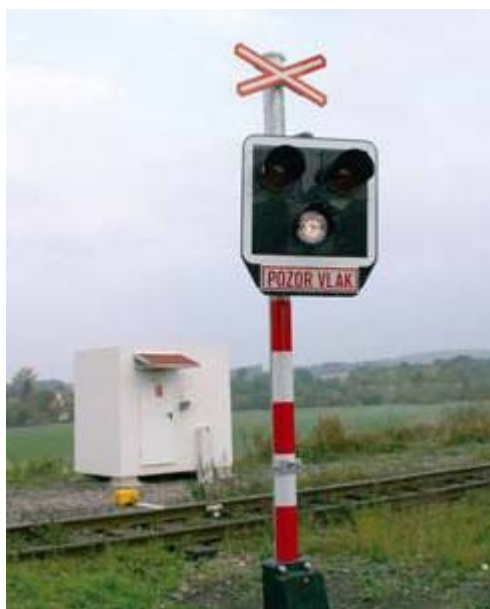
Obr. 7 – Přejezdové zabezpečovací zařízení typu PZZ - RE
