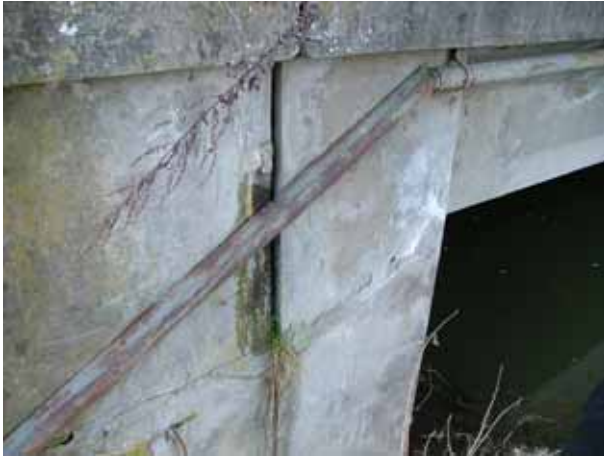
Obr. 3: Detail prasklého mostního křídla
