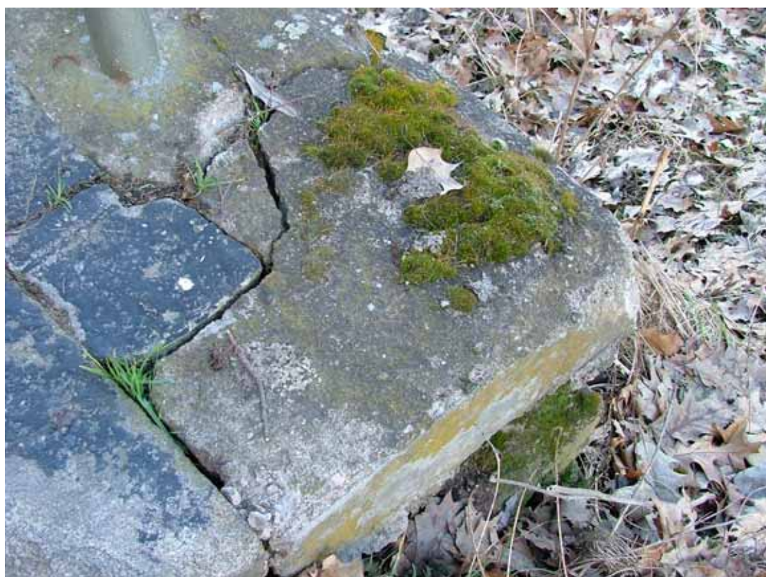
OBR. 13 – trhliny na římse
