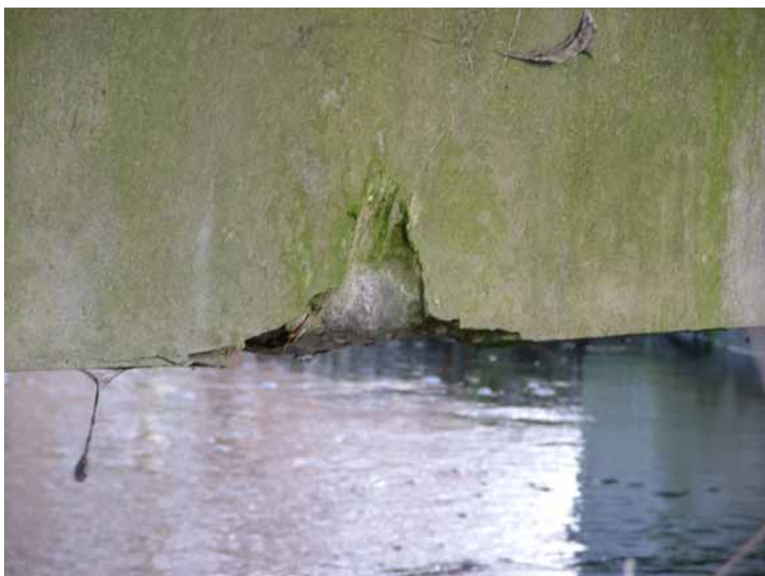
OBR. 19 – porucha na nosníku
