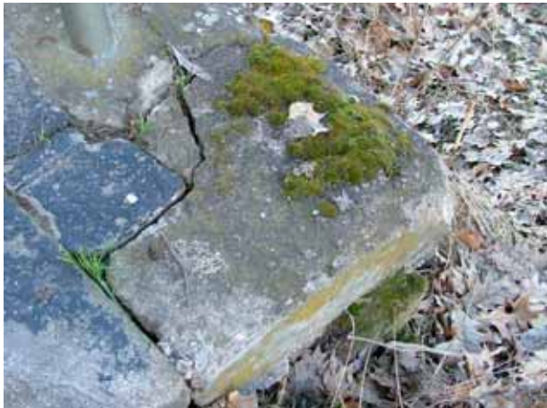
Obr. 1: Detail prasklé římsy
