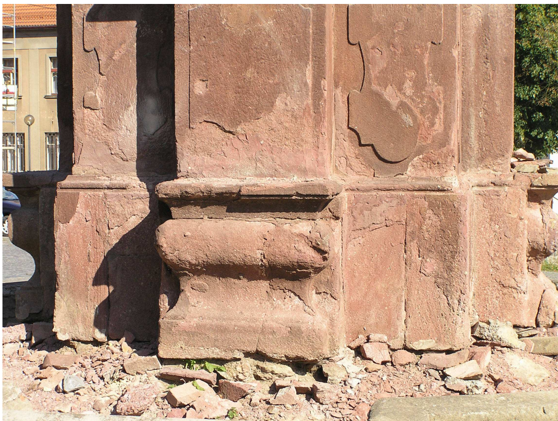
Obr.21 – odpadávající vrchní vrstva kamene
